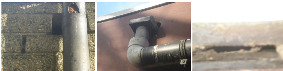
Foto's: Potentiële openingen voor vleermuizen
